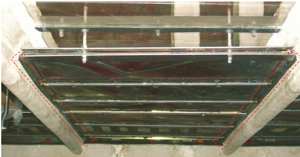
Figur 1: Bleilappen (rot gerahmt) innerhalb eines Schutzverglasungssystems.
