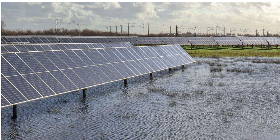
Abbildung 25 Hier ist die PV-Anlage auf dem Standort bei Lottorf zu sehen
