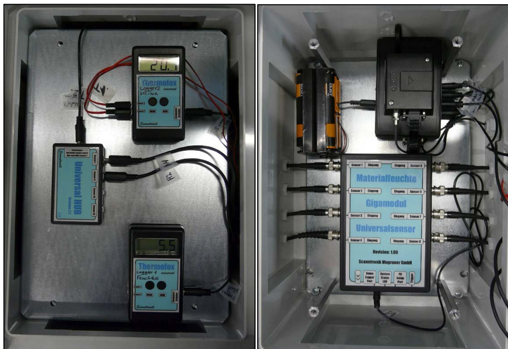
Abbildung 3: Innenansicht eines Installationskastens (li. obere Ebene, re. untere Ebene)
