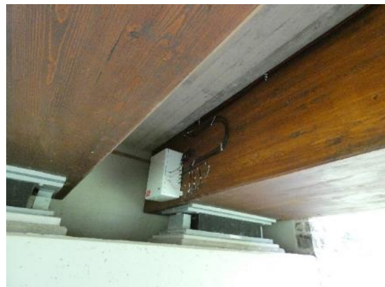
Installationskasten und Messstelle MS1
