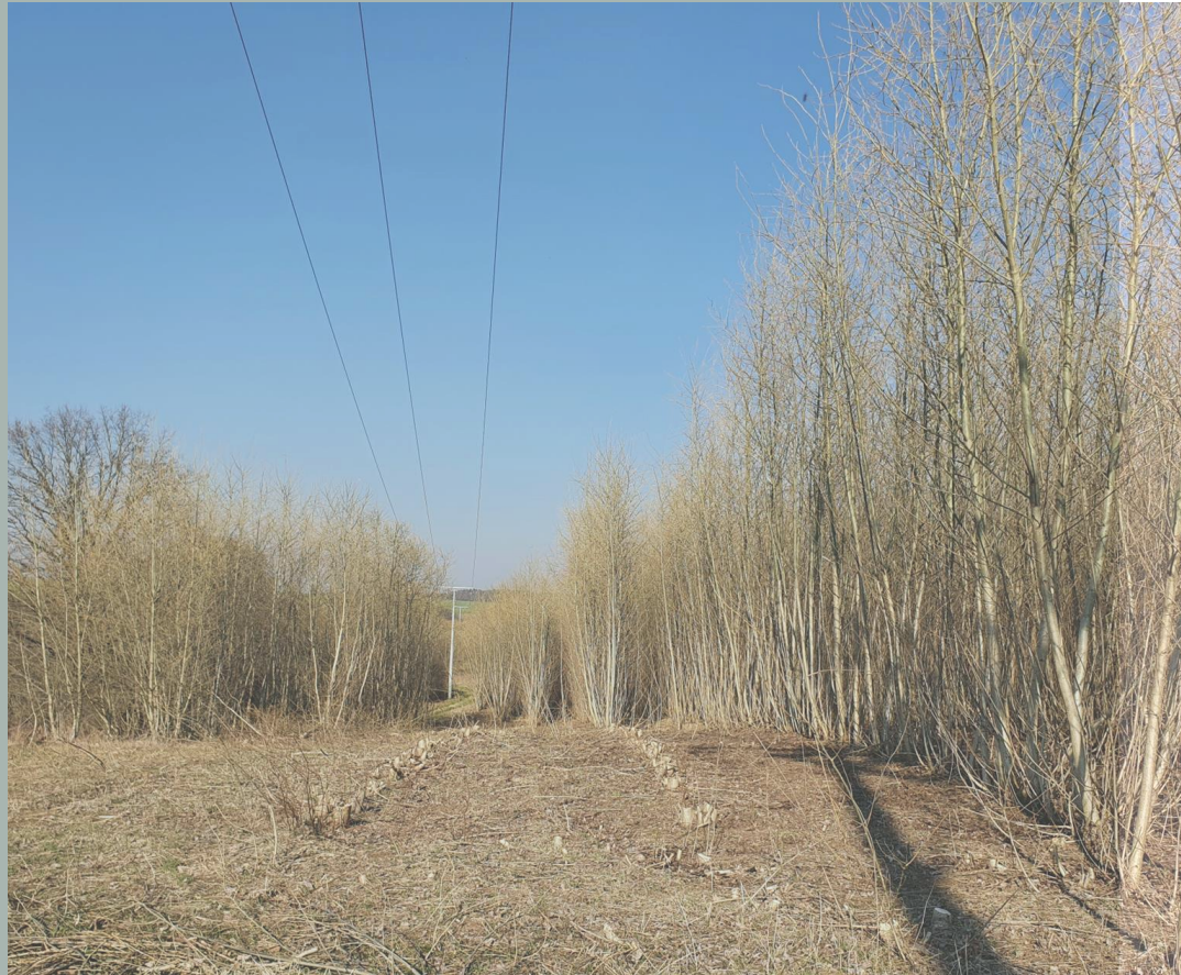
Stromtrasse auf der Untersuchungsfläche (23. März 2022)
